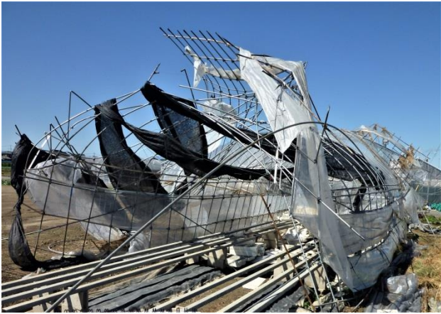
台風被害の様子
