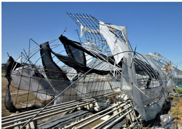
台風被害の様子
